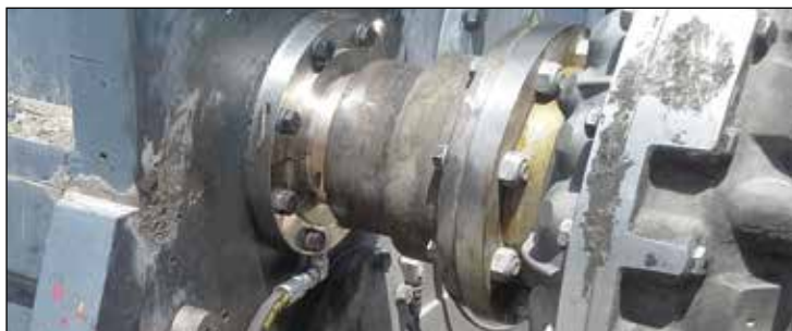
Es wurde ein externer Abfluss konstruiert, um der Überflutung im Lagergehäuse des SAG-Mühlengeriebes Rechnung zu tragen.
